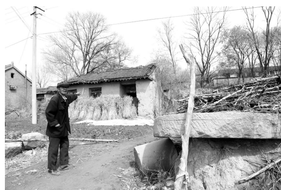
阎育几乎坍塌的老院子
